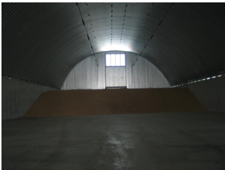
48. ábra Újépítésű síktároló, betárolás homlokrakódó géppel.
