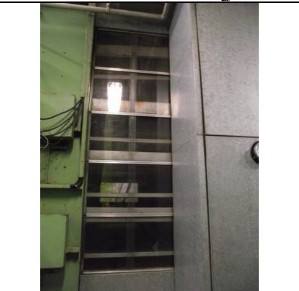
A Binder szárító berendezés ellenőrző ablakai, (5 szinten vezetett szalag)
